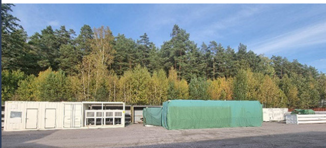
The electrolyzer in Finspång
